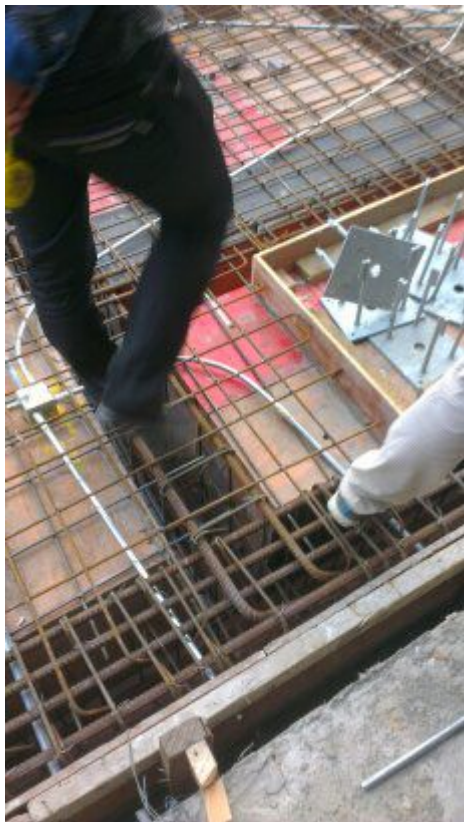
24、部分板节点漏筋，缺少下排筋
