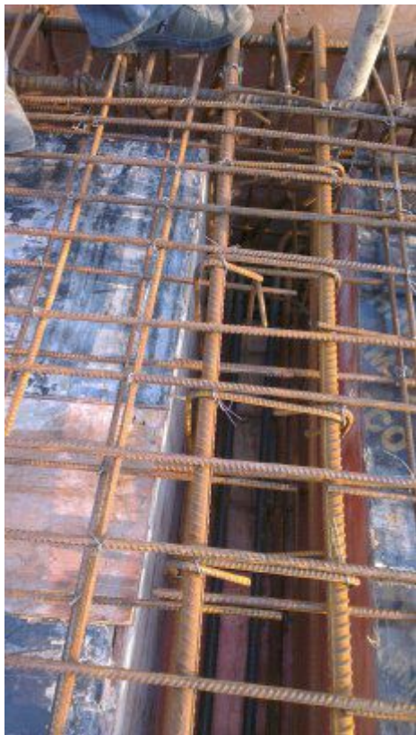
12、二排筋未提起绑扎到位
