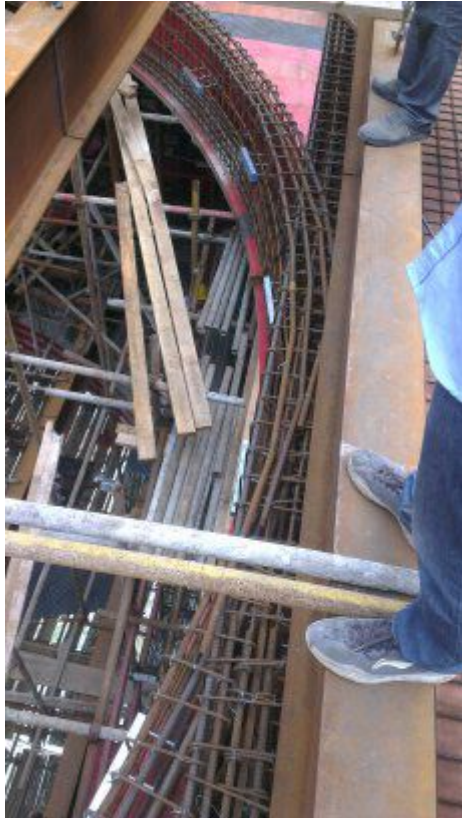
4、特殊节点部位，箍筋未箍住纵筋
