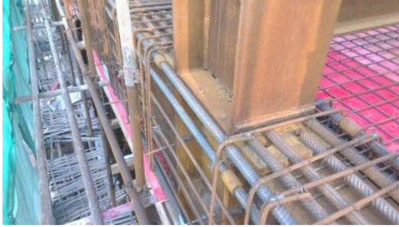
3、型钢结构中腹板箍筋不得缺少
