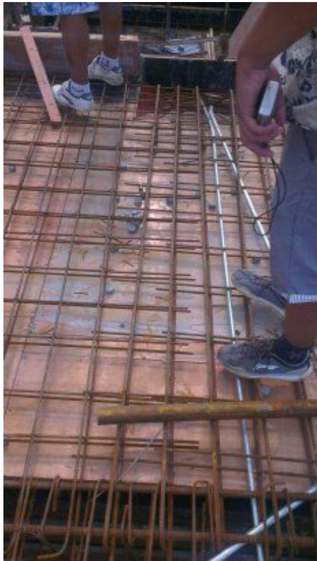
5、梯板处钢筋下料错误，接头未错开
