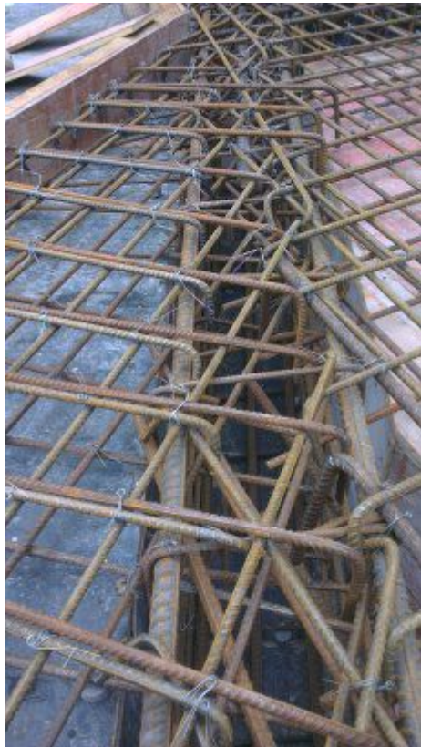
22、悬挑板上部筋锚固长度不足需补强
