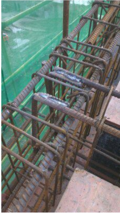
25、梁节点钢筋下料过长，截断重新搭接焊
