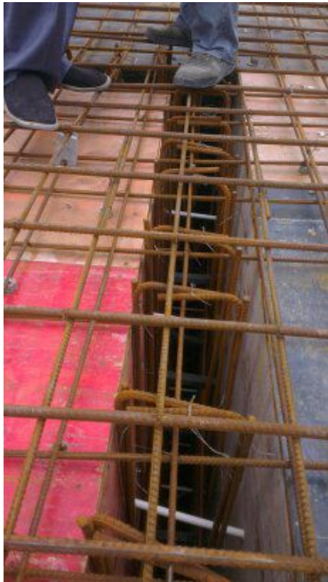
20、灭顶剪力墙无顶部加强筋
