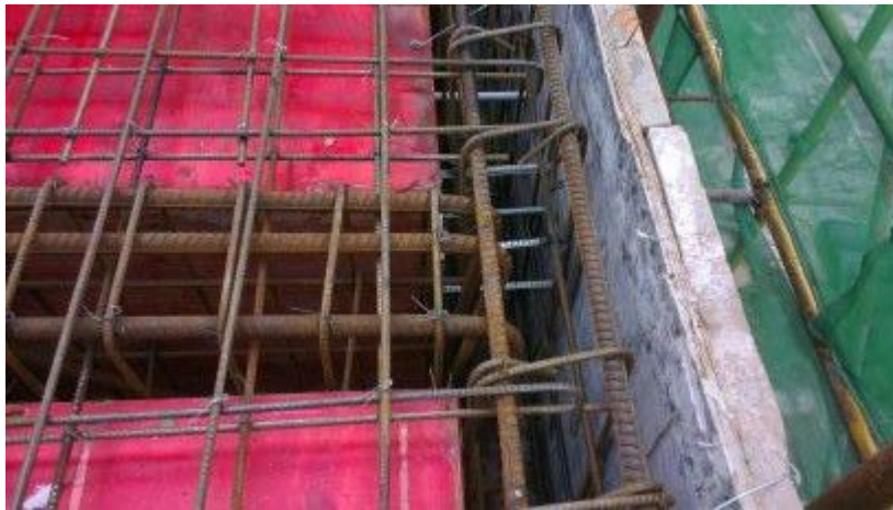
2、主次梁节点处锚固长度不足
