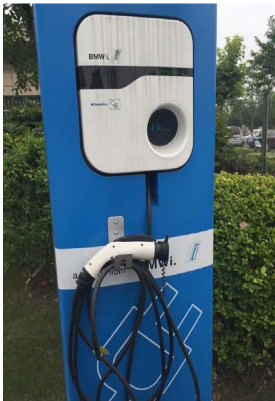
图6-1-13停车位桩体式充电桩
