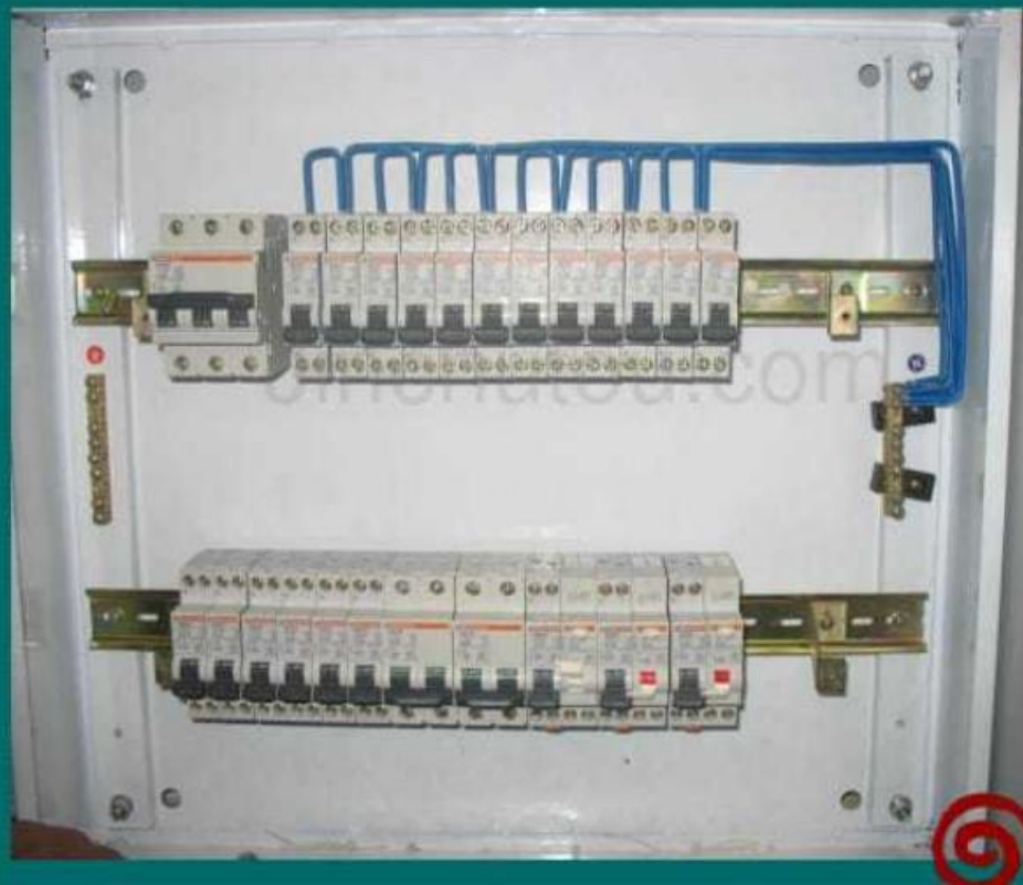
空开零线配线照片（第一排）：
