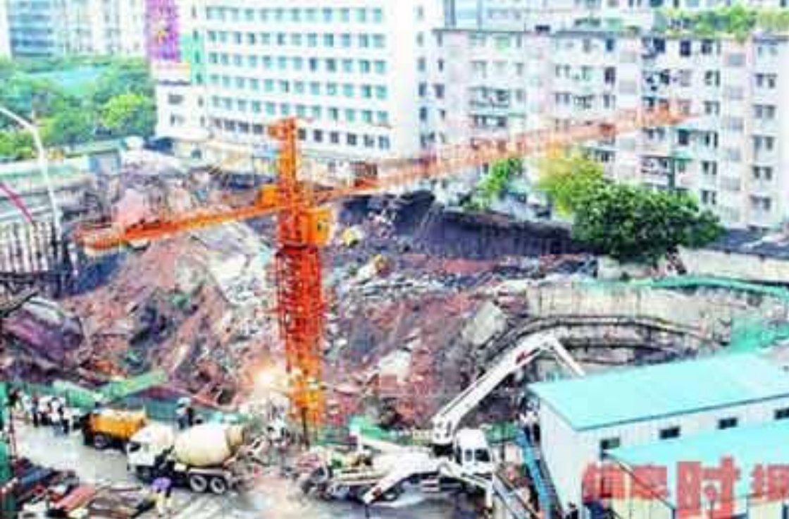
左图：塌方现场
